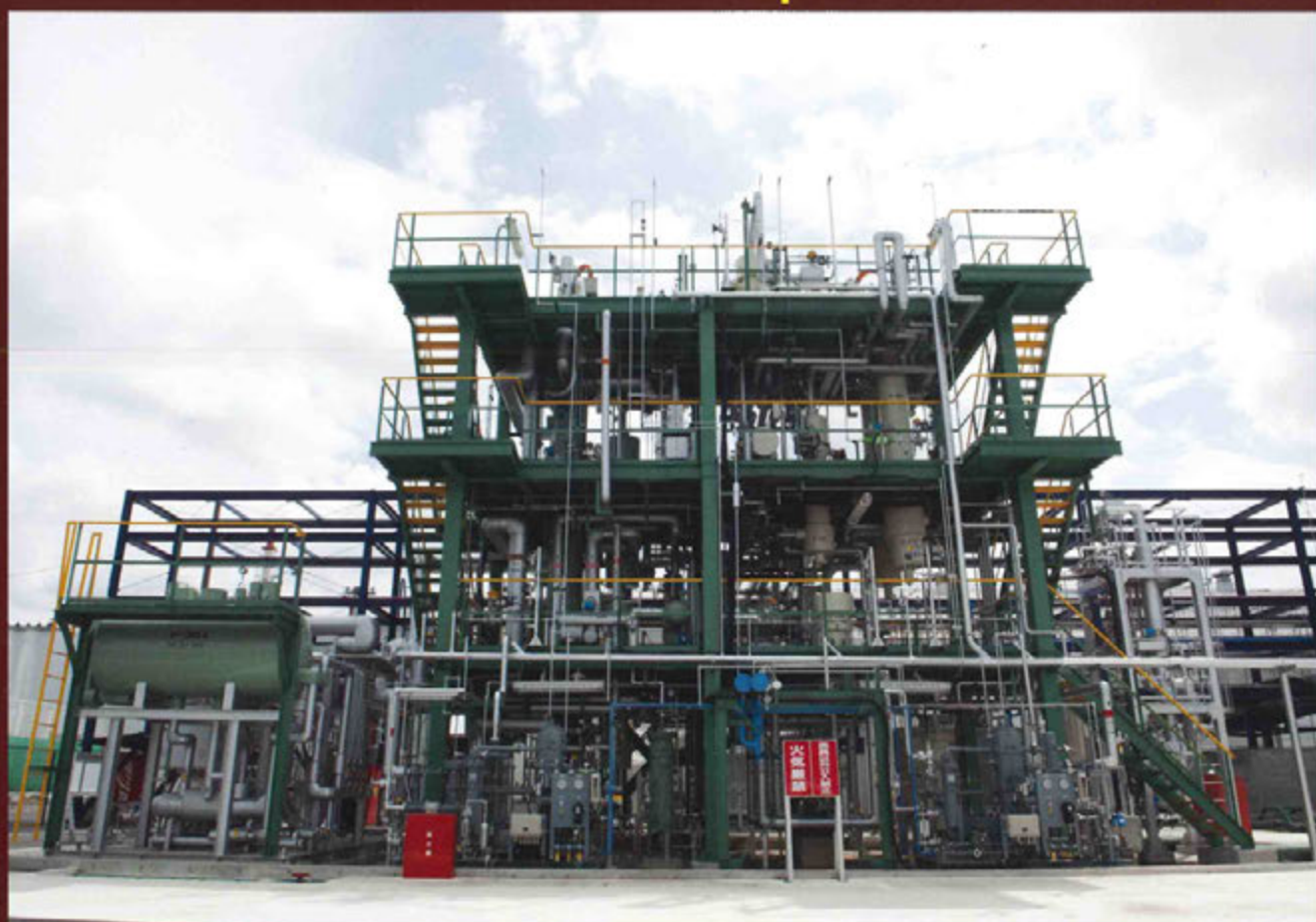
千代田化工建設・子安オフィス・リサーチパークの水素化・脱水素デモプラント
